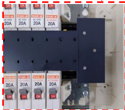
写真4 内部の状態 (母線カバーは一例です)
